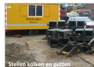
Stellen kolken en putten
